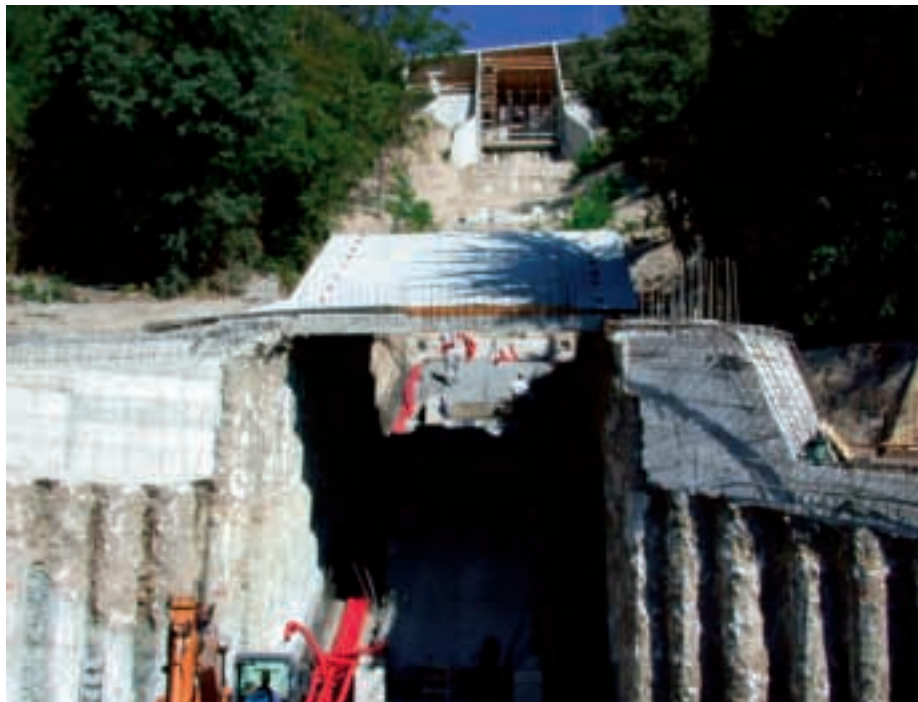
In questi giorni si stanno ultimando i lavori delle strutture portanti dell'impianto di risalita un'opera imponente per la quale il sindaco Latini sta lavorando dall'inizio del suo mandato e che, se i tempi saranno rispettati, verrà inaugurato per le festività natalizie.
